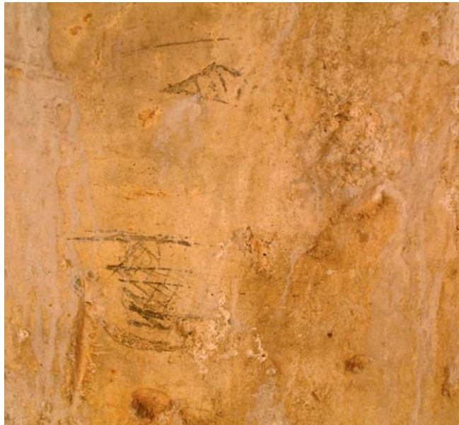
FIGURA 47 Galera grafiada en el mortero de la junta de la muralla Baluarte de Sant Bernat. Eivissa
