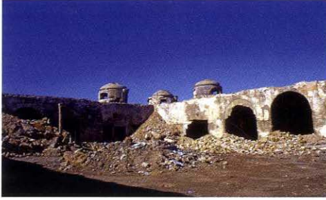
Fig. 9: Interior del castillo de San Antonio, actualmente en obras de restauración. Fotografía del autor.
