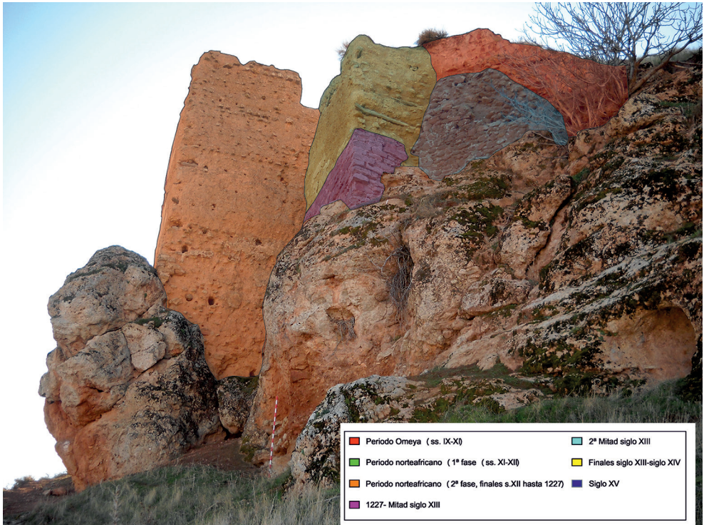
FIG. 7.- FRENTE NORESTE DEL CASTILLO DE MONTIEL, CON LA SECUENCIA CONSTRUCTIVA DEL MISMO.
