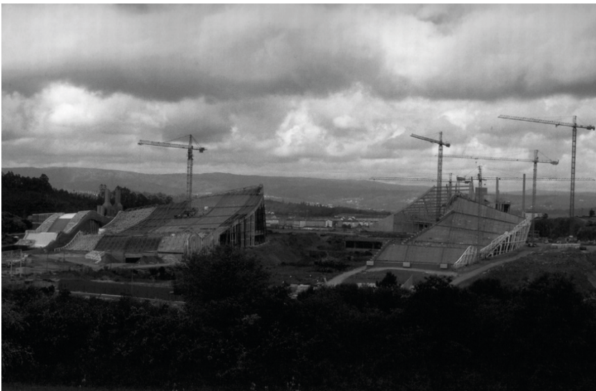
FIGURA 6. VISTA GENERAL DE LA CIDADE DA CULTURA EN CONSTRUCCIÓN Mayo de 2006. Fotografía de Alberto Valle Souto.
