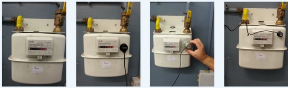
Figura 1: Ejemplo de grabación de señales de audio con micrófonos de contacto para detección de fallos y manipulaciones de contadores de gas.
