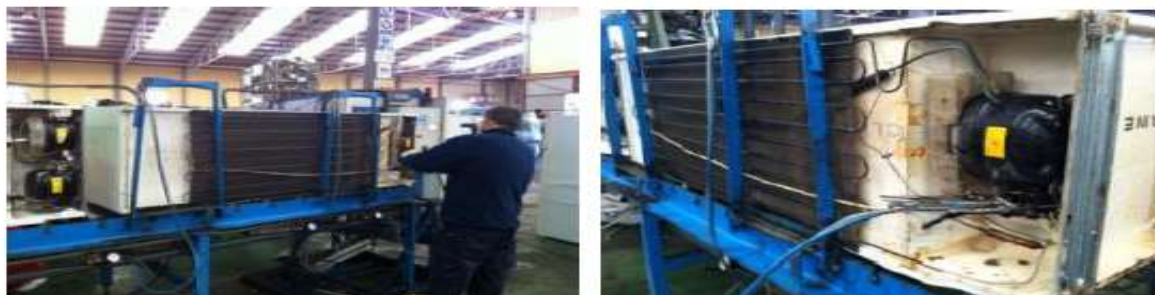
Fotografías 5.2.2.- Detalle de la retirada de cables y la extracción de gases refrigerantes y aceites.
