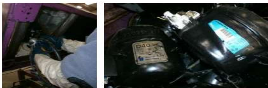
Fotografías 5.2.3.- Detalle de otro sistema de la extracción de gases refrigerantes y aceites del circuito a través de un orificio realizado en el compresor. Nótese que el compresor ha de estar limpio de aceite.
