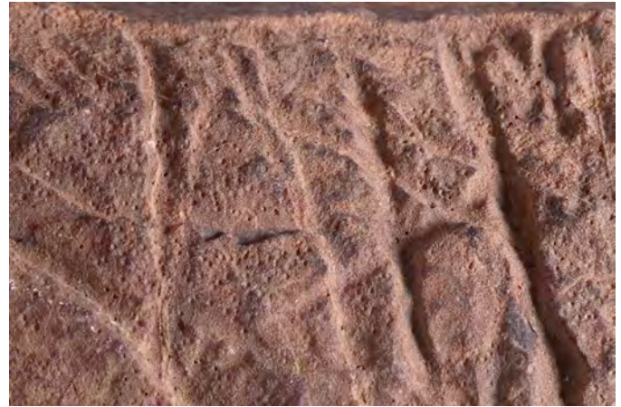
Foto 34. Plaqueta 2, anverso. Detalle de meteorización superficial (B. García).
