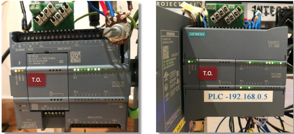
Figura 53: PLC S7 1200, instalados en la CAI-1.
