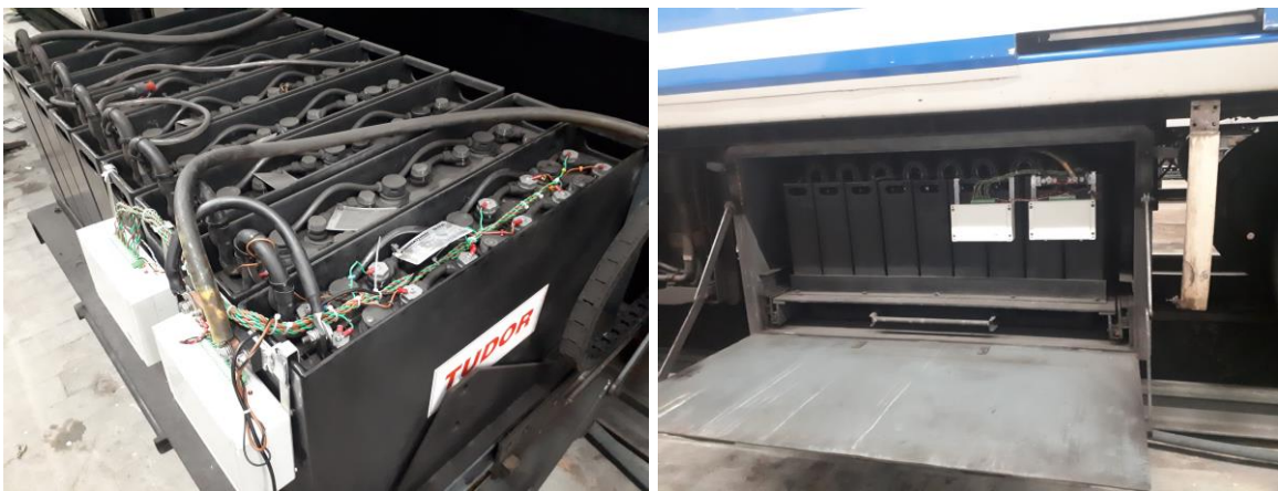
Figura 102: Sistema captador en la 1ª Celda de la batería del coche 2711.
