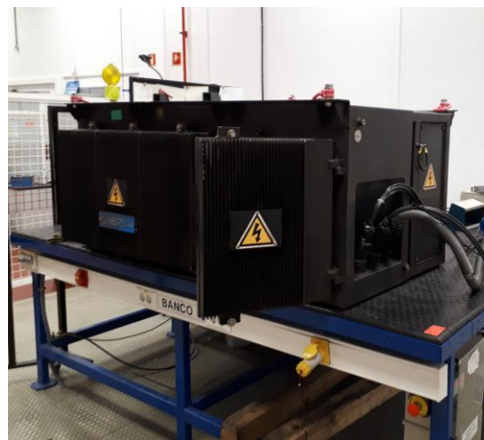
Figura 94: Convertidor 60kVA 2000B.
