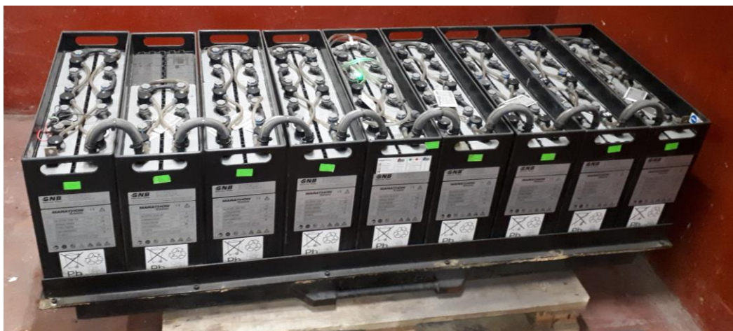
Figura 36: Batería de los coches 5000-4ª.
