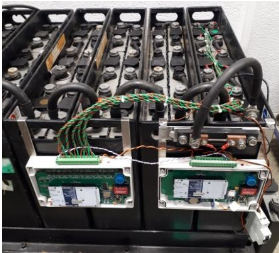
Figura 93: Sistema captador en 1ª Celda.
