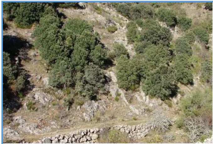
Fig. 301. Detalle de los muros de contención cerca del Puente los Grazos. Imagen realizada por C. Sánchez Piñán.
