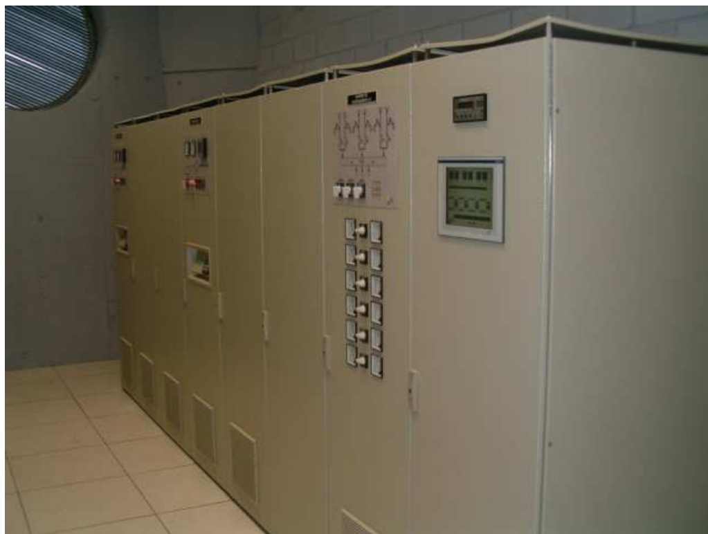
Figura 2.5: Sala de inversores del SFCR FORUM.
